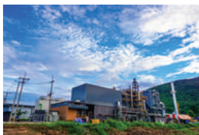
หม้อไอน้ำ (Boiler)
