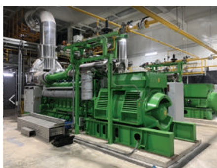
Gas Engine และ Generator
