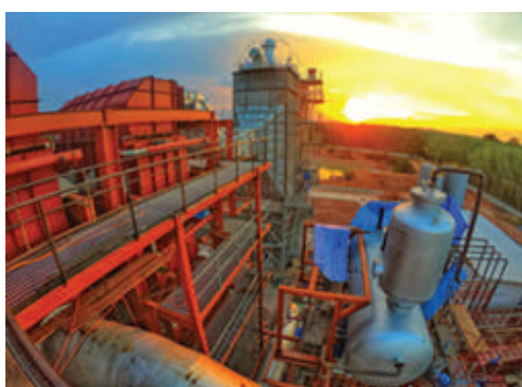
หม้อไอน้ำ (Boiler)
