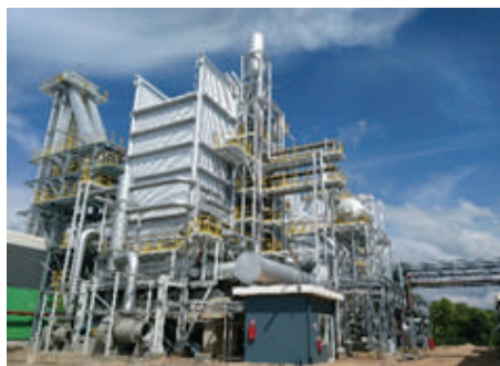
หม้อไอน้ำ (Boiler)
